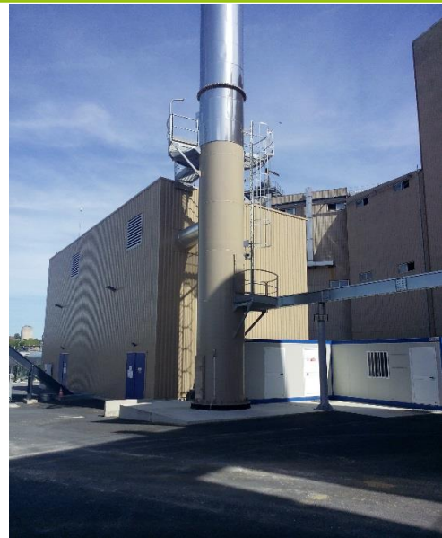
Figura 2: Caldaia Vyncke negli stabilimenti di Boortmalt (Issoudun, Francia)
